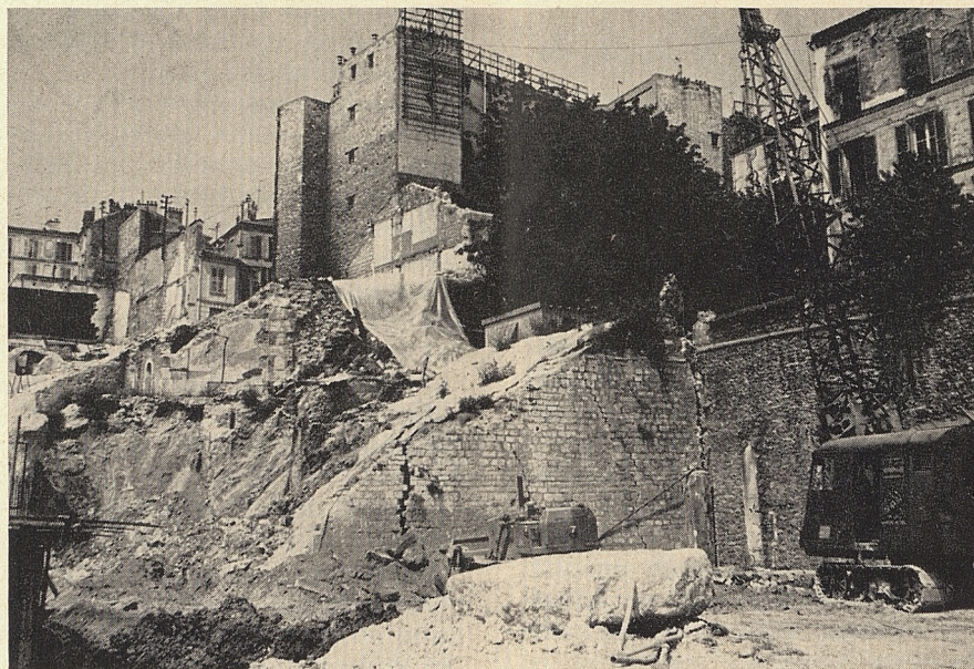
Les immeubles menacés d'effondrement.
